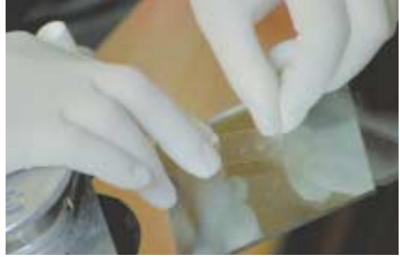
6 Colocación de una lámina de celofán para evitar la salida de la resina inyectada.
